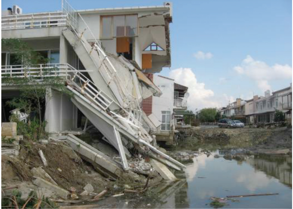
Şekil 4.35: Bina temelinin sel dolayısıyla boşalmasıyla meydana gelen yıkılma (Dalgıç ve diğ., 2015).
