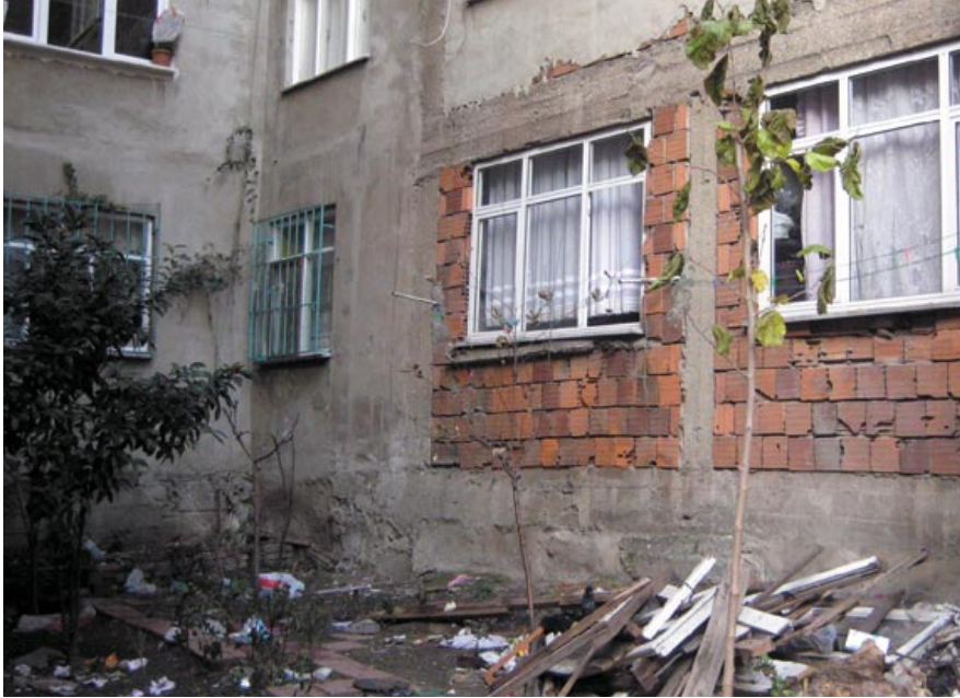
Tuğla ve inşaat atıklarına maruz kalan ev
