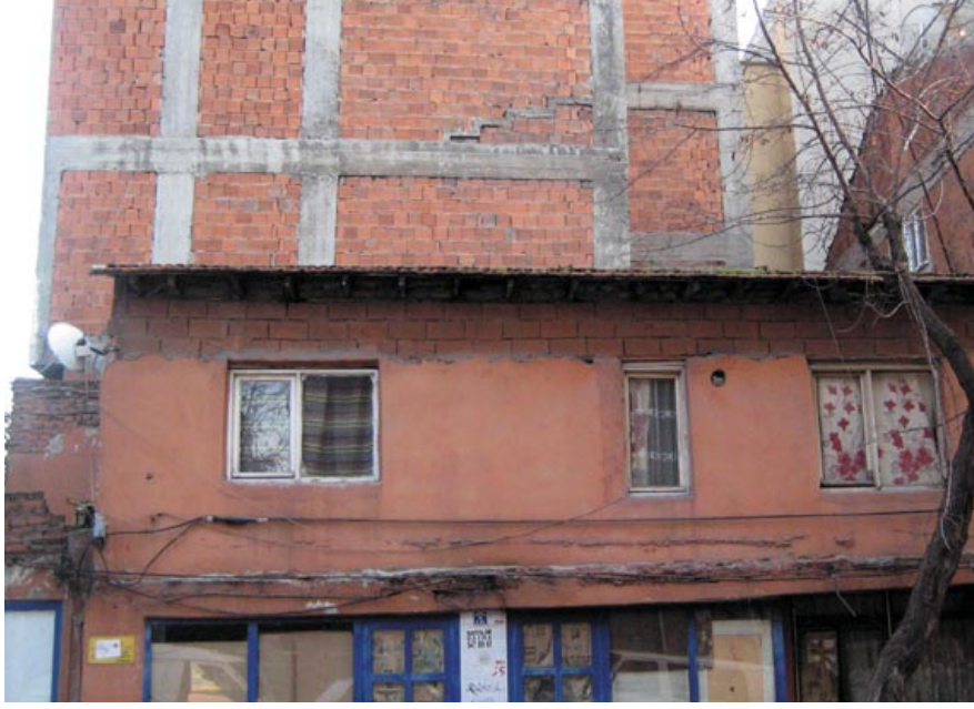
Bina dıřındaki kablolara maruz kalan ev
