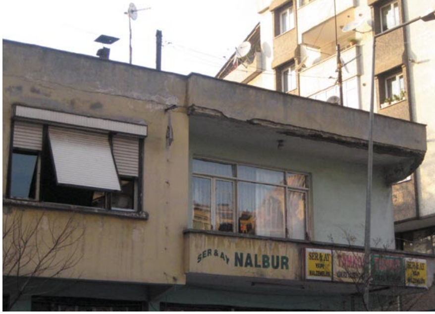
Zarar görmüş balkon
