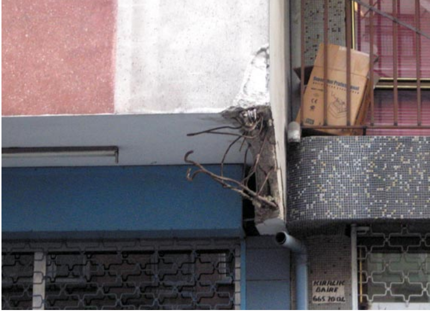
Yakın çekim inşaat demirine maruz kalan ev
