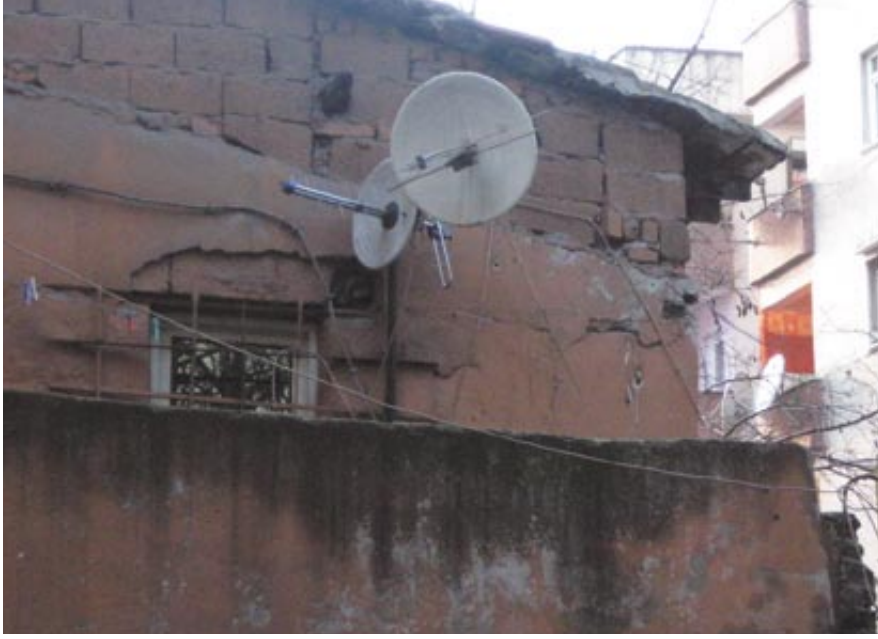
Yakın çekim yıkık teras
